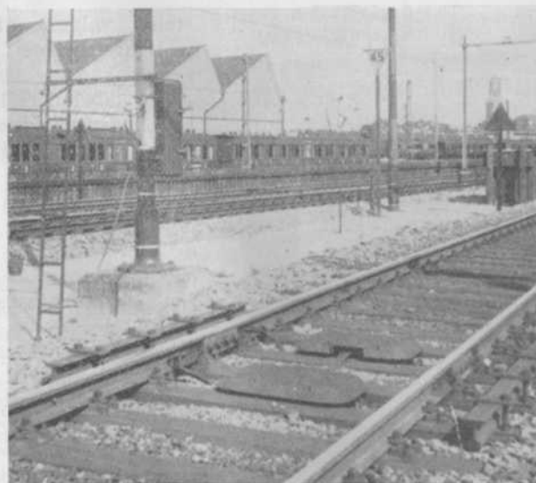
Afb. 10. Impedans-verbindingen in het spoor.
